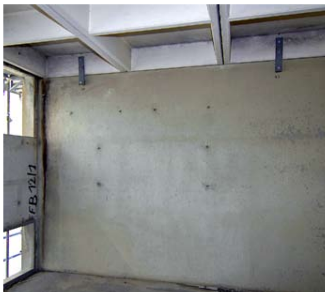
Attaches appliquées a posteriori pour relier le plancher en caissons aux parois.
